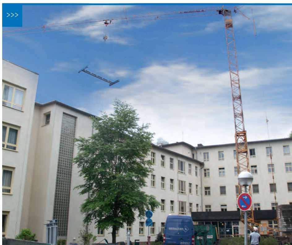
Baukran vor dem alten Eingang. Der alte Eingang des KKH am Kratzberg bleibt auch nach Fertigstellung der Baumaßnahmen geschlossen. Im Eingangsbereich entsteht ein moderner Multifunktionsraum.
